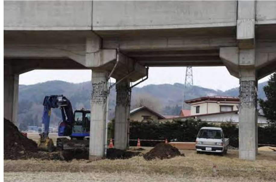
東北地方太平洋沖地震で被災したRC橋梁
