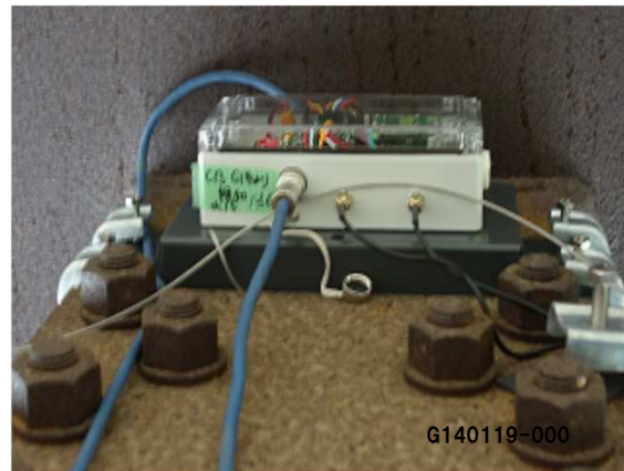
センサノード設置例(横桁上フランジ)
