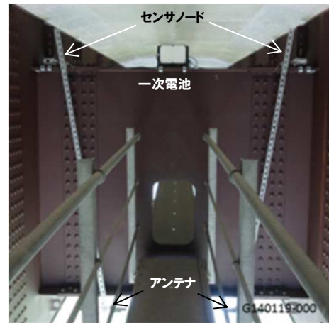
センサノード設置例(横桁)
