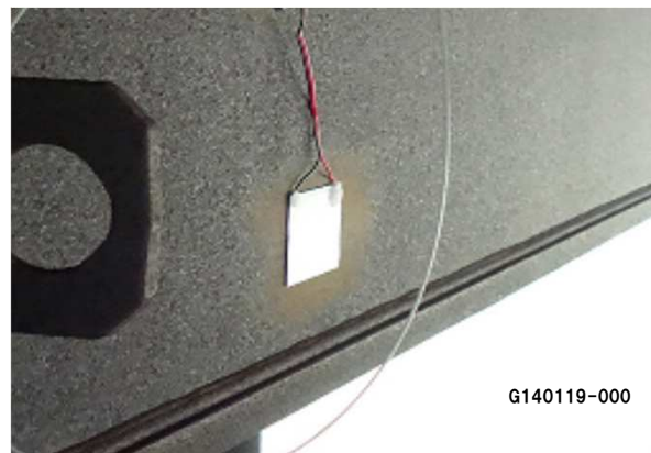
ACM型腐食センサ設置例(箱桁外面)
